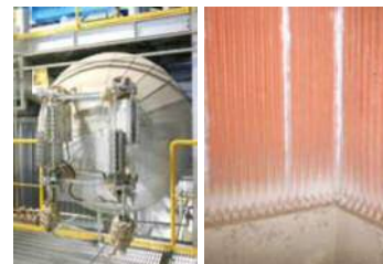
3 ボイラ本体 ボイラ内部
