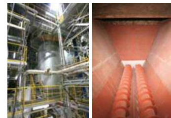
4 減温塔 減温塔内部
